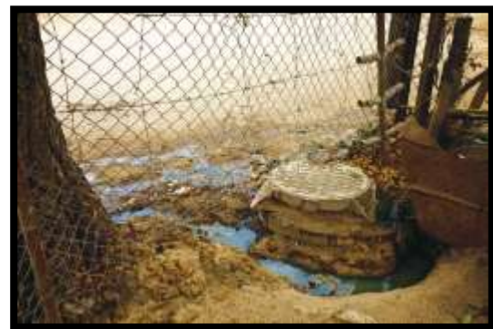
(d) Blocked drainage pipes
